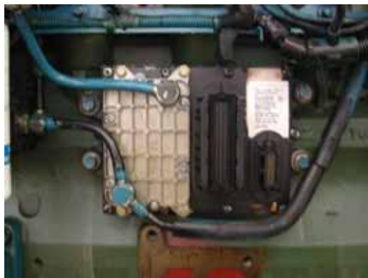
Vista frontal do módulo PLD localizado abaixo das unidades injetoras e fixado no bloco do motor
